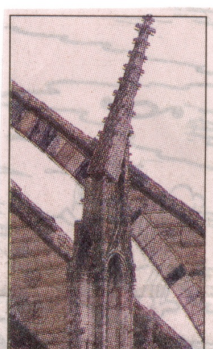
Sturmschaden an der Notre-Dame-Kathedrale
